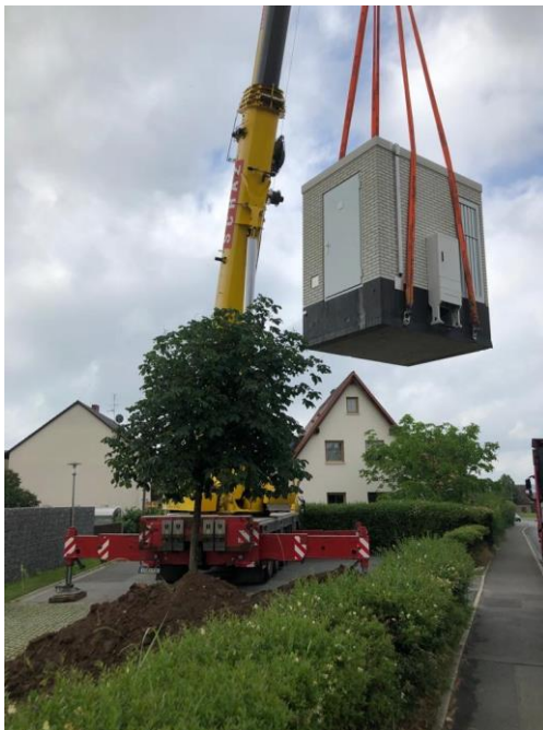
Der neue PoP in der Siegeldorfer Straße gegenüber der Einmündung Astenstraße schwebt in Seukendorf an seinen neuen Standort
